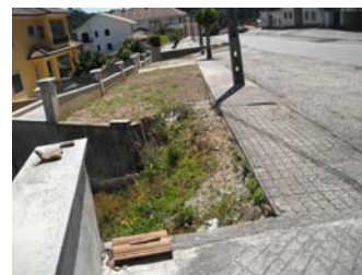
Inexistência de Guarda-Corpo Rua de Timor Leste
