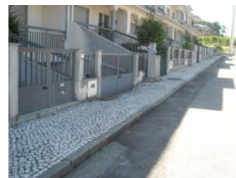
Rebaixamento para veículos mal desenhado Trecho n.º 254
