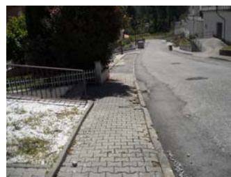
Pavimento em mau estado Rua de Moçambique
