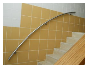
Corrimão inacessível na Piscina Municipal
