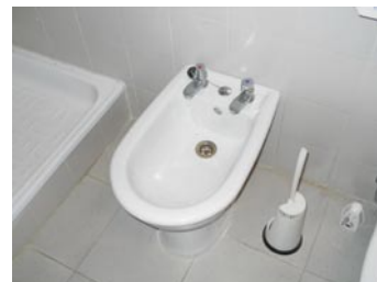
FIG. 38 - Mecanismos operáveis inacessíveis e degrau no duche
