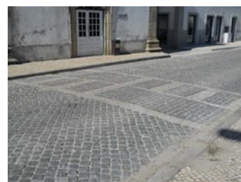
Passadeira não rebaixada com pavimento inacessível
