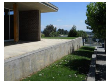
Desnível sem guarda-corpos no recinto da Piscina Municipal
