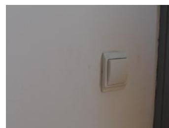
Interruptor na Câmara Municipal
