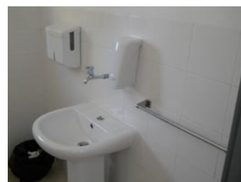
FIG. 19 - Lavatório com mecanismo operável inacessível
