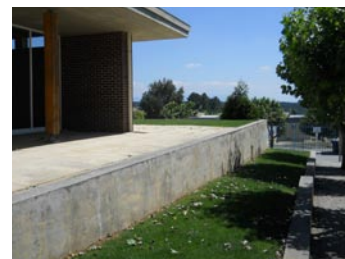
FIG. 8 - Falta de guarda-corpos
