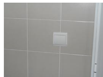
FIG. 29 - Interruptores sem luz de presença
