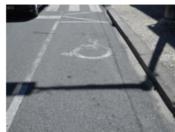
Lugar de PMC mal sinalizado e sem faixa lateral
