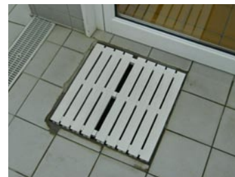
FIG. 33 - Grelha mal assente
