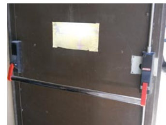
FIG. 8 - Portas de saída de emergência
