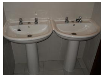
FIG. 28 - Lavatórios com mecanismos operáveis inacessíveis
