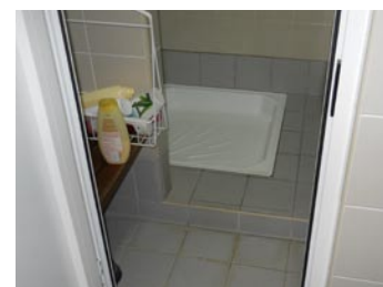
Espaços reduzidos com ressalto no acesso ao duche da Piscina
