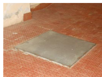
FIG. 29 - Tampa saliente no pavimento
