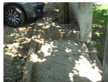
Passeio descontínuo e com obstáculos junto à Piscina Municipal
