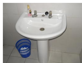
FIG. 35 - Lavatório com mecanismos operáveis inacessíveis
