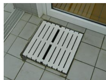
Grelha mal assente
