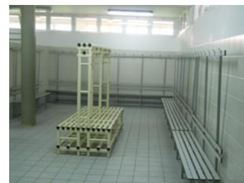
Cabides e bancos inacessíveis na Piscina
