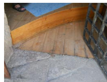
FIG. 7 - Degrau isolado no patamar interior
