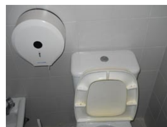
FIG. 36 - Sanita com mecanismo operável inacessível
