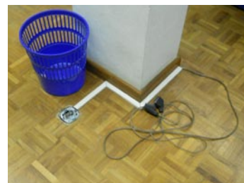
FIG. 48 - Tomadas de pavimento na sala de audio-visual
