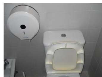
FIG. 39 - Sanita com mecanismo operável inacessível
