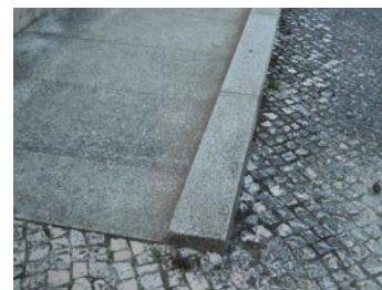
Rampa de acesso à Câmara Municipal não possui corrimãos
