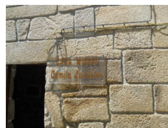
Sinalização ilegível no exterior do Museu Camila Loureiro
