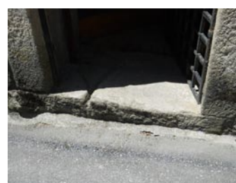
FIG. 5 - Degrau isolado no acesso ao interior.
