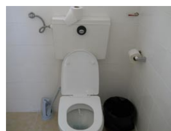
FIG. 20 - Sanita com mecanismo operável inacessível
