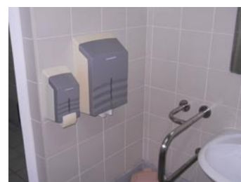
Instalações sanitárias adaptadas com acessórios acessíveis
