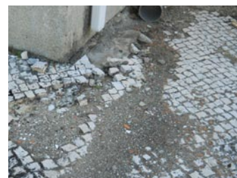
FIG. 8 - Pavimento irregular e em mau estado
