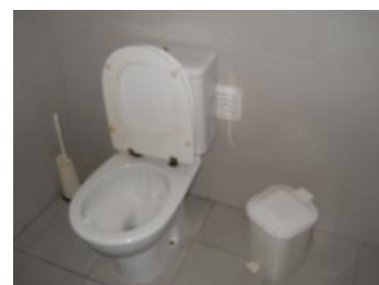
FIG. 29 - Sanita com mecanismo operável inacessível
