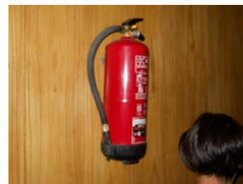
Extintor saliente no percurso do auditório no Cinema
