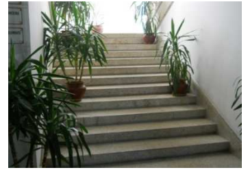
As escadas principais da Câmara Municipal não têm sinalização de alerta e, pela colocação de vasos em vários degraus junto às paredes, são um enorme perigo para pessoas invisuais, tornando-as absolutamente inacessíveis.
