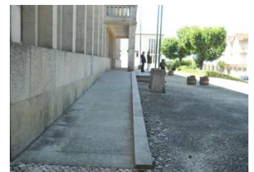
Rampa de acesso ao edifício da Câmara Municipal constitui um perigo para os seus utilizadores com mobilidade condicionada ou invisuais, uma vez que não tem corrimão de proteção e de apoio.
