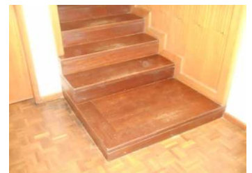
As escadas da Biblioteca Municipal não têm qualquer sinalização de tipo “aviso” nem qualquer corrimão ou apoio nos primeiros degraus, o que constitui um verdadeiro perigo para qualquer pessoa.
