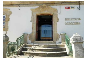
A Biblioteca Municipal tem portas em vidro mas sem faixas de alerta em cor viva e contrastante, o que constitui um perigo aos seus utilizadores.
