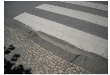
Passadeira da Av. Conde D. Henrique com a pintura em mau estado, com listas desgastadas e pouco visíveis.
