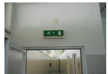
Na Piscina Municipal, o sistema de emergência fornece apenas informação visual com pictogramas e luz.
