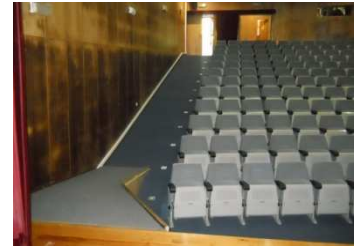
A rampa da plateia do Cine Teatro, pelo acentuado declive que regista, constitui um sério perigo para quem se desloque em cadeira de rodas, tornando-se mesmo inacessível para uma pessoa com mobilidade condicionada.
