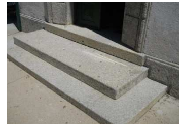
No edifício da antiga Escola, as escadas tornam inacessível acesso aos diferentes serviços aí sediados a pessoas com mobilidade condicionada.
