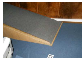
Na plateia do Cine Teatro esta rampa acentuada não tem qualquer faixa sinalizadora de alerta ou piso diferenciador, o que constitui um enorme perigo para qualquer pessoa.
